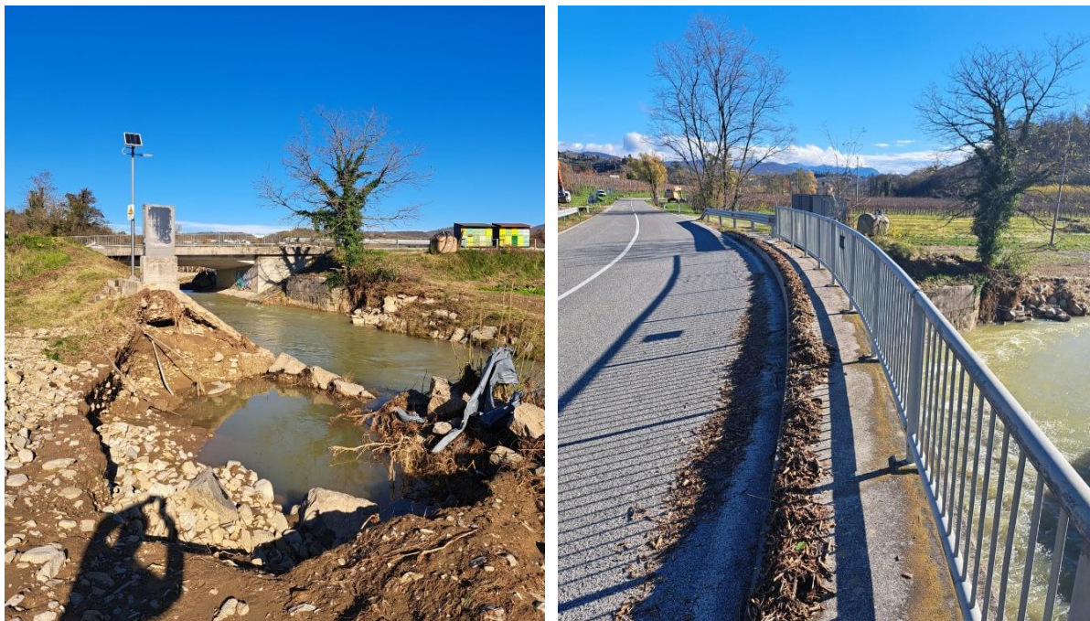
Slika 7. Poškodba desnega brega pri vodomerni postaji Kožbanjšček Neblo (levo) in sledi visoke vode na mostu pri vodomerni postaji (desno) (fotografiji: arhiv ARSO)
